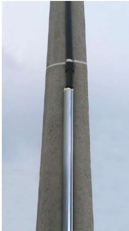
Foto ilustrativa 01 dos anexos D, E, H e I – Detalhe do eletroduto junto ao poste
